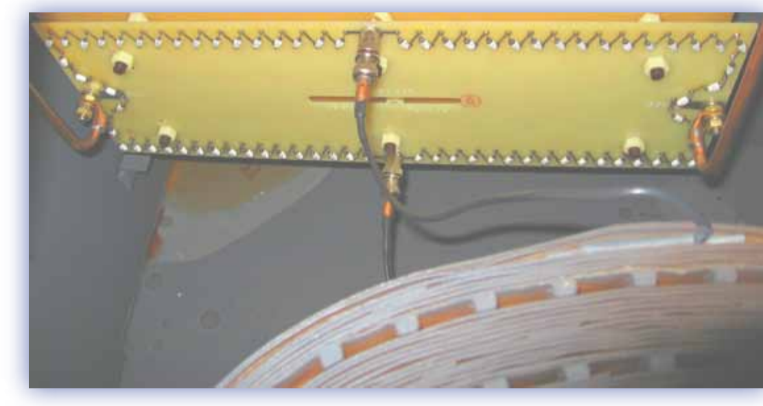
TRANSFORMER RECTIFIER (TR SET)
